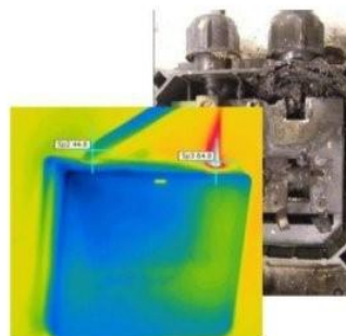
(b) corrosion dans la boîte de jonction
